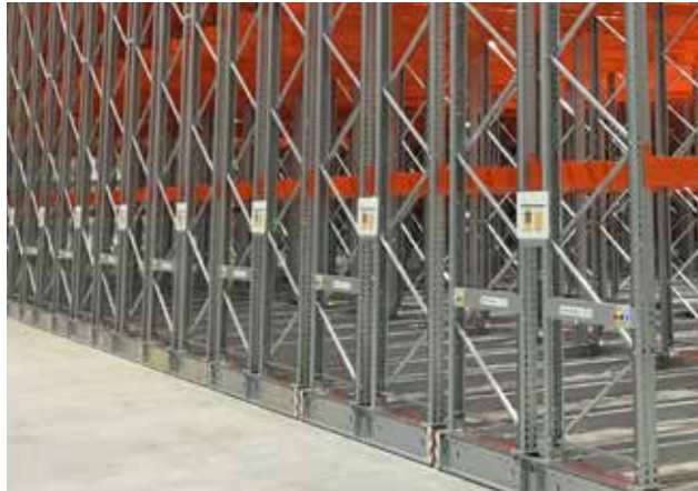
Des boutons d'arrêt d'urgence situés à l'extérieur du rayonnage permettent d'arrêter le palettier mobile en cas d'urgence.
